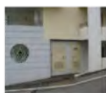
Cabine Intégrée en immeuble
